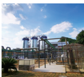
桂林南药污水处理系统
