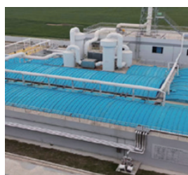
苏州二叶污水站
